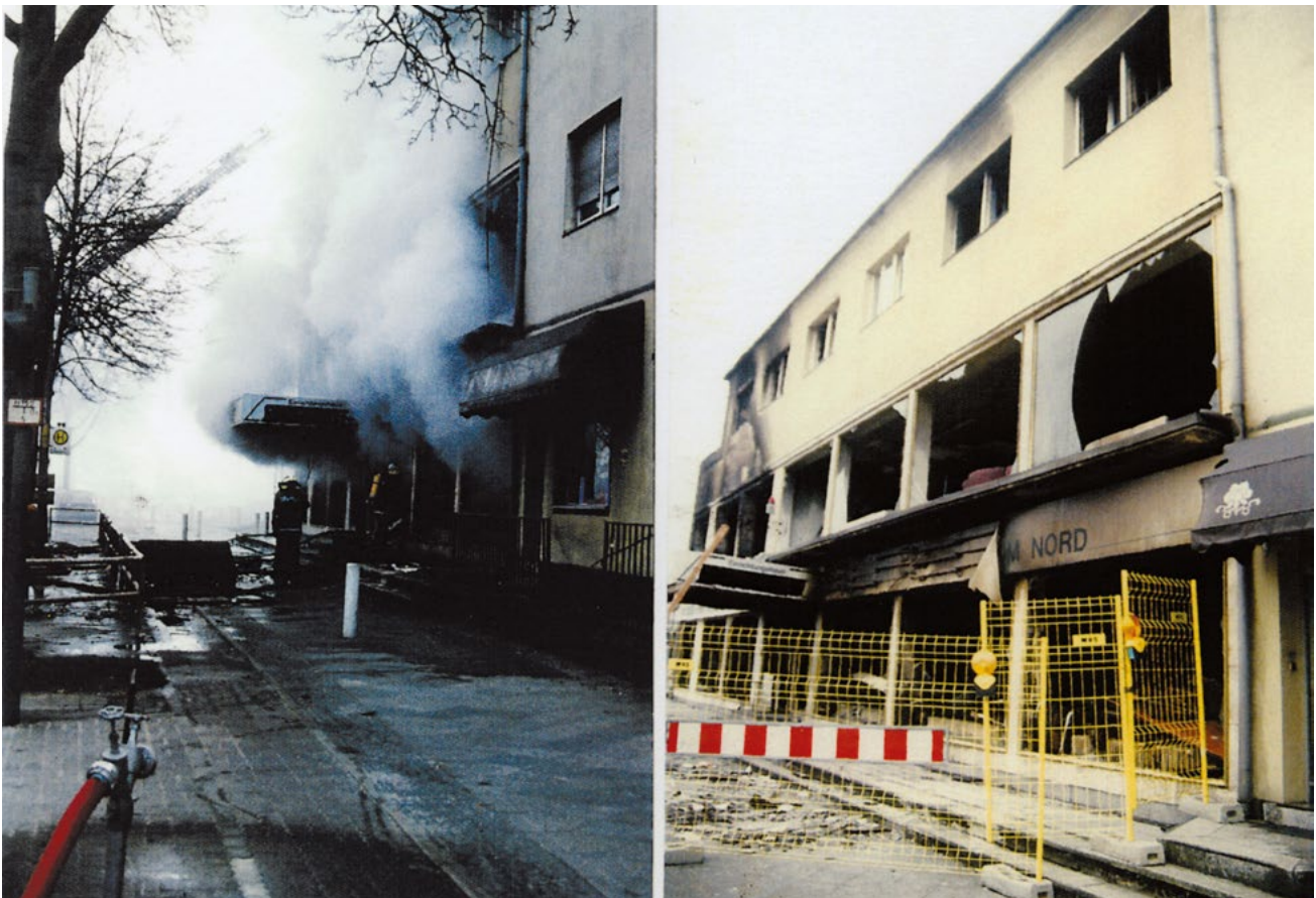
Abb. 2.2: Geschossübergreifendes Brandereignis durch aufsteigenden Rauch außerhalb der Gebäudefassade, Brandentstehung im EG (linkes Bild), nach dem Brand (rechtes Bild).
