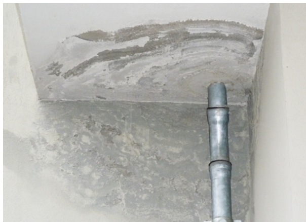
Bild 1: Feuchteschaden durch mangelhafte Abdichtung eines Balkons (Bild: Oster, IFDB, Berlin)
