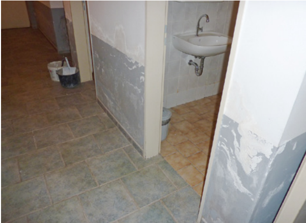
Bild 2: Feuchteschaden durch aufsteigende Feuchte infolge einer mangelhaften Abdichtung im Gründungsbereich (Bild: Oster, IFDB, Berlin)
