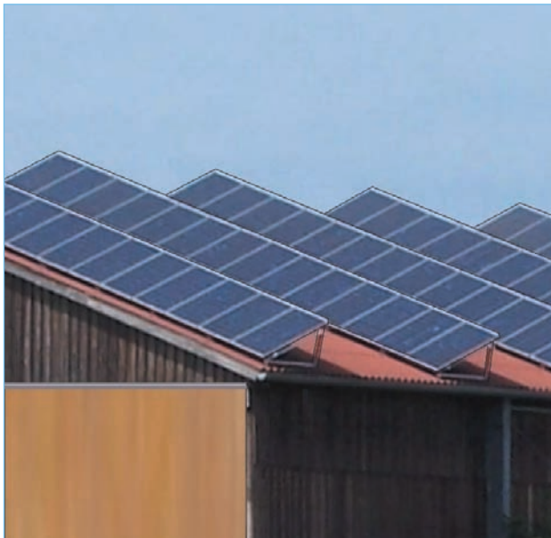
Abb. 5.2 – Hochgestellte Solarmodule auf dem Dach eines landwirtschaftlichen Objekts.
