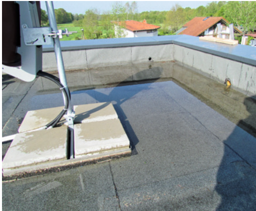
Abb. 1.3: Bei dieser ca. 3 Jahre alten Abdichtung verbleibt ebenfalls Restwasser. Im Bereich der Pfützenbildung ist bereits der sog. mud-curling-Effekt erkennbar.
