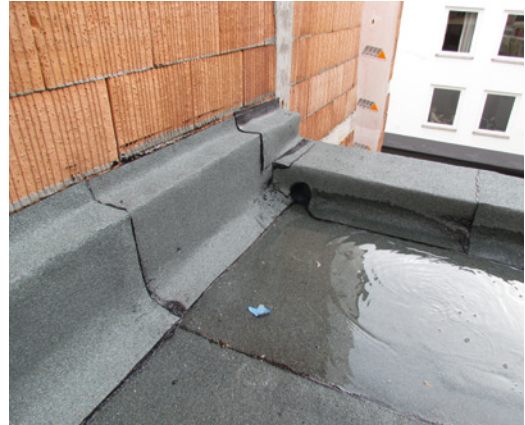
Abb. 1.2: Bei dieser Bauwerksabdichtung wurde das Gefälle nur in einer Richtung erstellt. Gleichzeitig ist der Ablauf zu hoch eingebaut.
