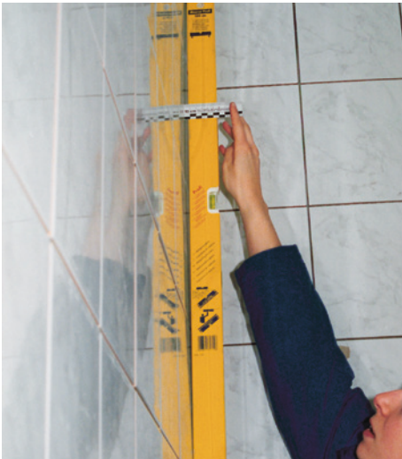
Abb. 1.11: Unzulässige Abweichung von der Ebenheit bei Wandfliesen: 10 mm bei einem Messpunktabstand von 1 m
