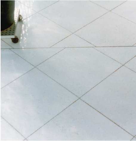
Abb. 1.18: Treffpunkt von Fliesen bei einer Verlegung, die von 2 unterschiedlichen Räumen begonnen wurde (optischer Mangel)
