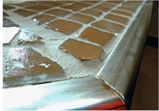
Abb. 1.10: Verletzungsgefahr durch scharfkantige Glasfliesen im Sitzbereich einer Badewanne
