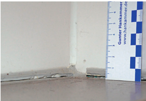
Abb. 1.7: Fugenabriss in der Raumecke nach abgeklungener Estrichschüsselung
