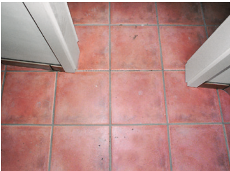
Abb. 1.16: Die Verlegerichtung verläuft nicht parallel zur Wand – ein deutliches Indiz dafür, dass die planwidrig nicht im 45°-Winkel zu den übrigen Wänden verlief.
