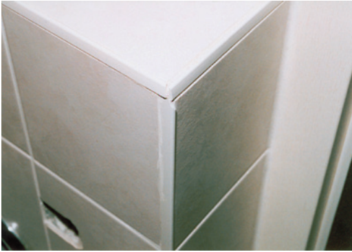
Abb. 1.9: Verletzungsgefahr durch unfachgerechten Kontaktpunkt der Kantenschutzprofile an der Installationsverkleidung
