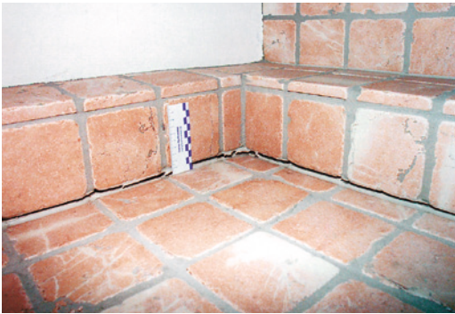
Abb. 1.5: Abgerissene Dichtstofffuge nach abgeklungener Estrichschüsselung
