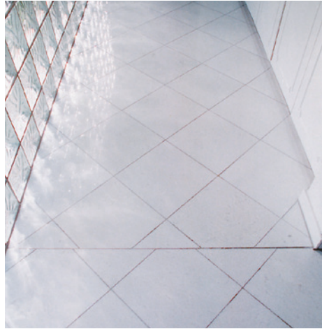
Abb. 1.19: Treffpunkt von Fliesenrastern bei einer Verlegung, die aus 2 unterschiedlichen Räumen begonnen wurde (optischer Mangel)
