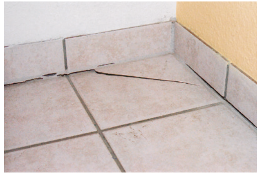
Abb. 1.6: Fliese nach abgeklungener Estrichschüsselung. Der Haftverbund der Eckfliese an der elastischen Fuge war größer als zum Untergrund hin.
