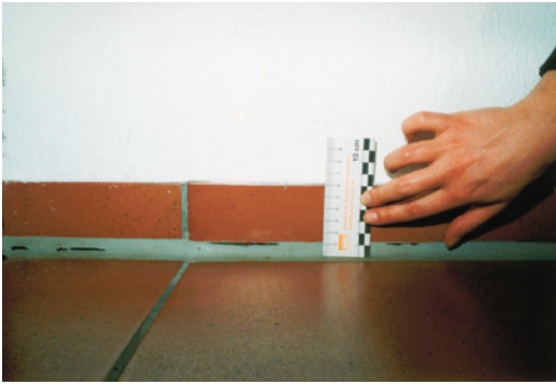
Abb. 1.3: Überbeanspruchung der elastischen Fuge unterhalb der Sockelfliesen, in der Mitte der Wand: 15 mm
